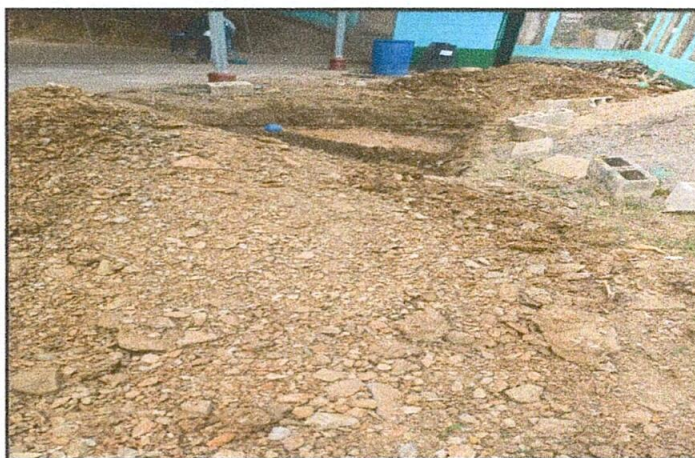
Foto 3: fosa septica en mal estado
