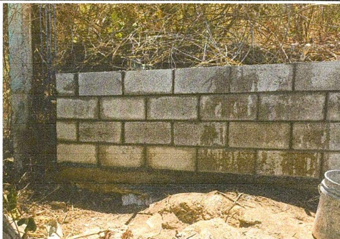
Foto 1: muro perimetral colapsando
