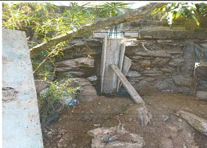
Foto 2: relleno del perímetro deteriorado
